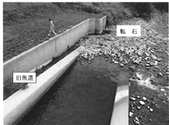
写真-2 旧魚道転石状況
