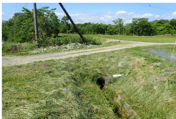
写真－１０ 町道側溝
