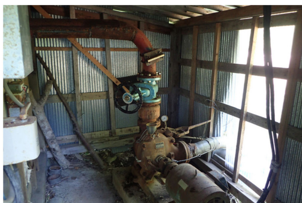
写真－７ 既設ポンプ
