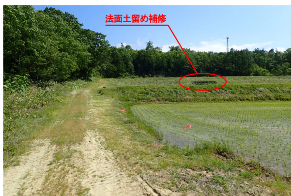
写真－５ 大きな田差法面
